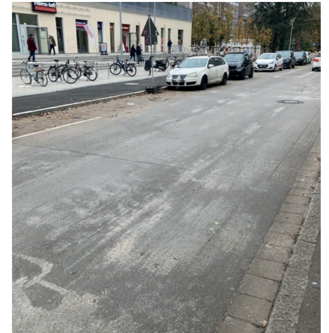
Alles andere als ein fußgängerfreundlicher Übergang....
