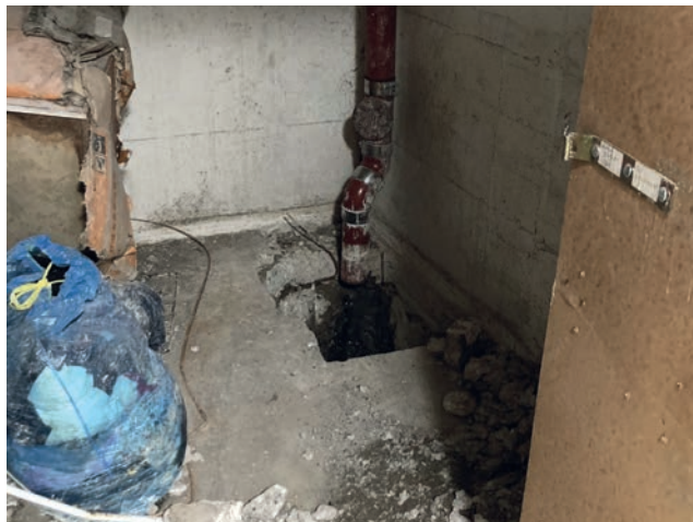
Eine der defekten Abwasserleitungen im Keller, Auwaldstr. 9
